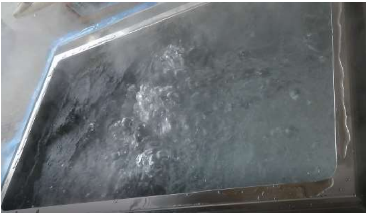
沸騰状況 写真では中心付近に沸き上がりがありますが、 据付後改造し、左寄りに沸き上がり対流するよう改良しました。
